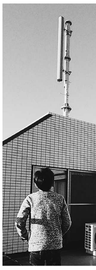
民間マンション屋上に設置された携帯電話基地局
