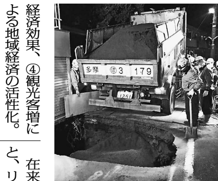
東京外環道陥没事故 (NEXCO東日本)
