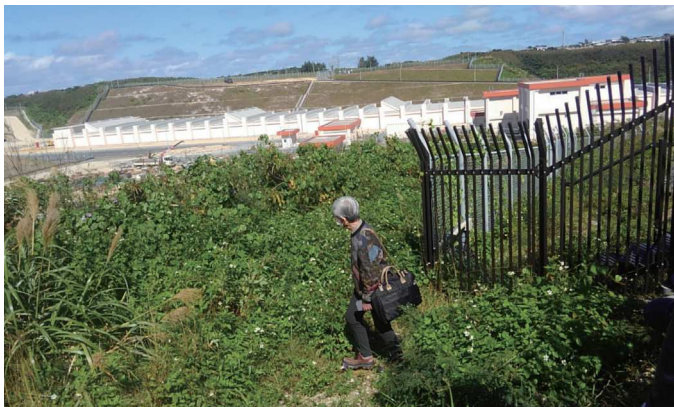
工事中の陸自保良訓練場、奥に300メートル伸びる射撃訓練場
